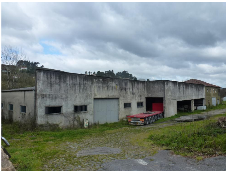
Figura 6: Armazém abandonado localizado na margem do Rio Vade
